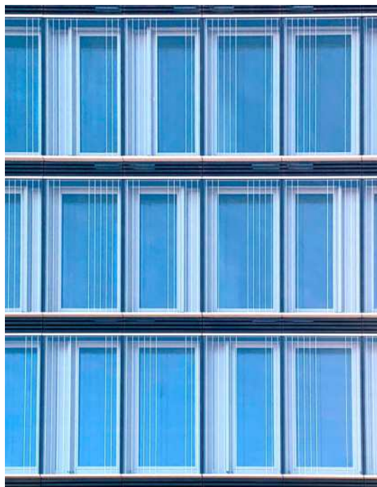
Zwar wurden an dieser Glasfassade zum Vogelschutz geprüfte Markierungen verwendet, da jedoch zu grosse Bereiche an jedem Fenster ausgespart wurden, kann es hier weiterhin zu Kollisionen kommen.
