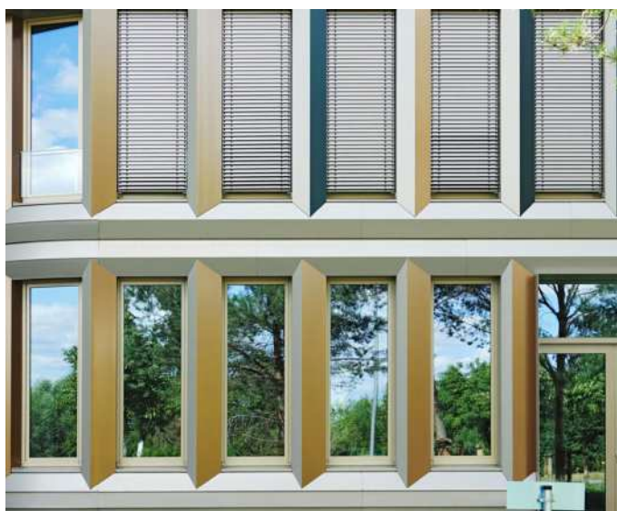
Im heruntergelassenen Zustand können Aussenjalousien vor Kollisionen schützen. Als dauerhafte Lösung eignen sie sich jedoch nicht, da diese Massnahme nutzerabhängig ist.
