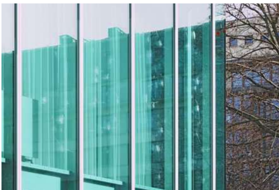
Die Kollisionsspuren zeigen deutlich, dass getöntes Glas keinen Anprallschutz bietet.
