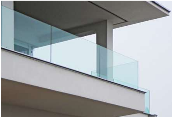
Vögel überfliegen oft in knappem Abstand die Gebäudekante, ohne die gläserne Brüstung wahrzunehmen.
