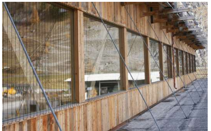
Nach wiederholtem Vogelanprall an den spiegelnden Fenstern einer Werkhalle in S-chanf wurden nachträglich im Abstand von 8–10 cm schwarze Nylo-schnüre gespannt. Im Anschluss an die Nachrüstung wurden keine Vogelkollisionen mehr dokumentiert.
